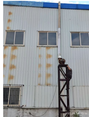
照片 13 排风管道
