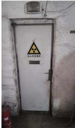
照片 2 操作门及指示灯
